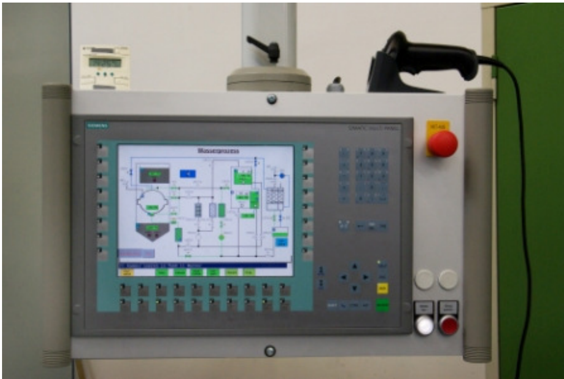
Übersichtlich und leicht zu bedienen: die Siemens Steuerung der Hösel-Anlage überzeugt durch vorbildliche Bedienerfreundlichkeit.
